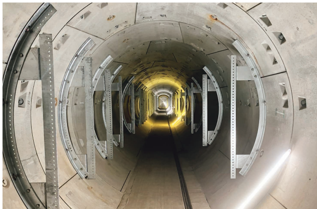
工事名：葛西橋通り付近管路新設工事 発注者：東京電力パワーグリッド株式会社
