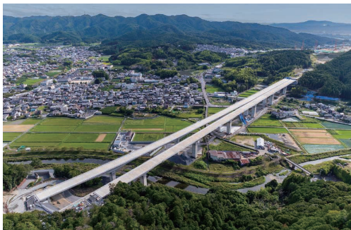
新名神高速道路 宇治田原第二高架橋(PC上部工)工事 (京都府綴喜郡) 発注者:西日本高速道路株式会社
