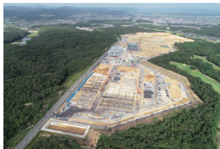
<右上写真> ひょうご小野産業団地造成工事 兵庫県 発注者：兵庫県
