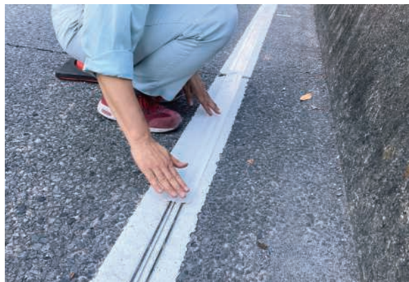
ケーブル状の光ファイバ設置状況
