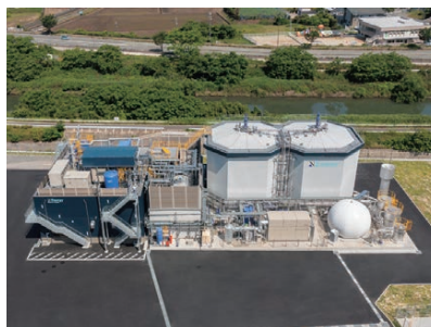
熊本西部バイオガス発電所
