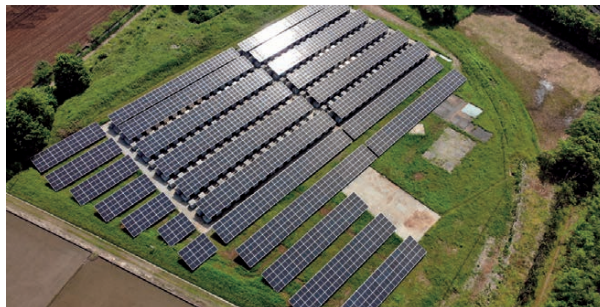
拡張地発電所
