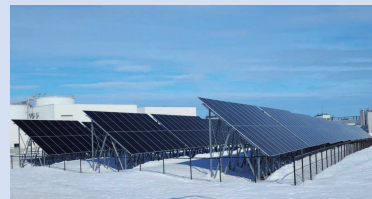
太陽光発電設備（大樹工場）
