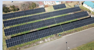
太陽光発電設備（磯分内工場）
