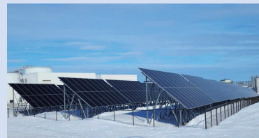
太陽光発電設備（大樹工場）
