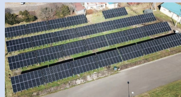
太陽光発電設備（磯分内工場）
