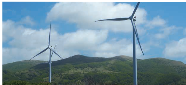
リエネ松前風力発電所
