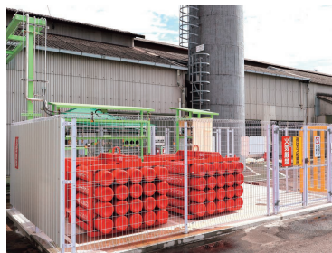
刈谷工場に導入した水素貯蔵設備
