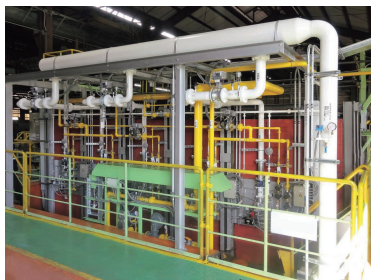
バーナを導入した鋼材熱処理炉（写真奥） と、炉側面に組付けられたバーナ・配管 （写真手前）（刈谷工場）
