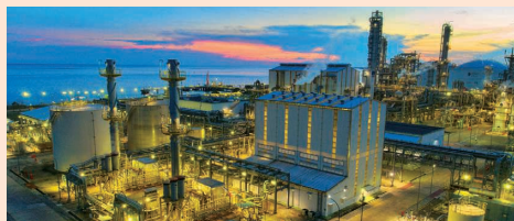
インドネシアにおけるアンモニアプラント
